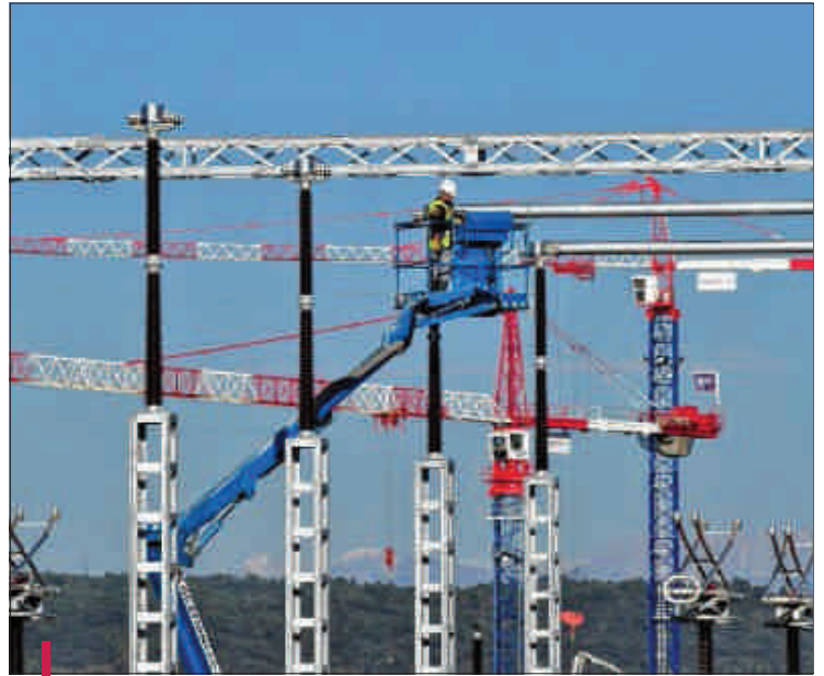
Quatre ans de travaux ont été nécessaires pour que la ligne 400 000 volts aille jusque sur le site Iter afin d'alimenter le tokamak. / PHOTO DR - IO
